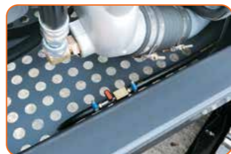
จุดระบายน้ำในถังน้ำมันเชื้อเพลิง
